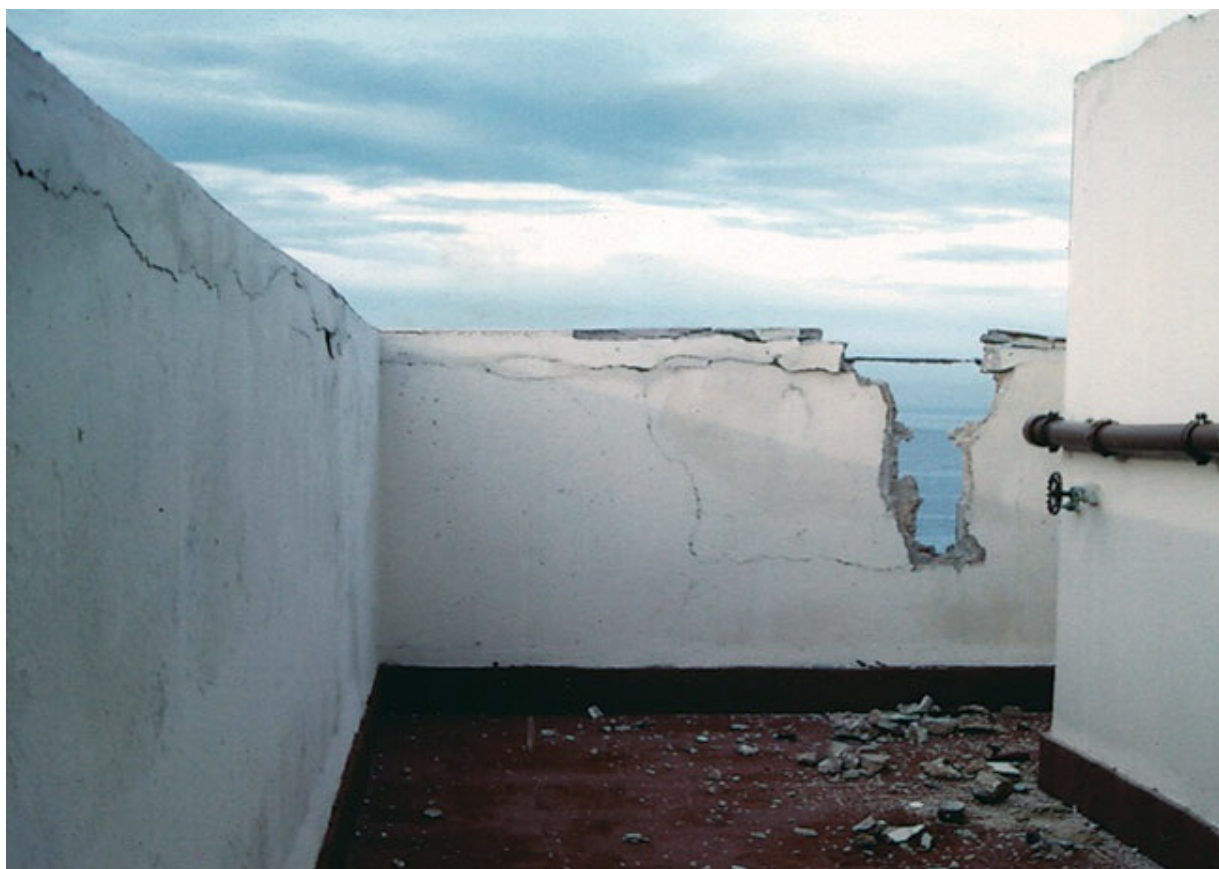
FIGURA IV.1. Vista del estrago causado por la caída de un rayo (mostrado parcialmente en la figura I.2). Nótese la grieta continua a la izquierda del boquete abierto y a nivel de la barra de acero de refuerzo del muro perimetral.
